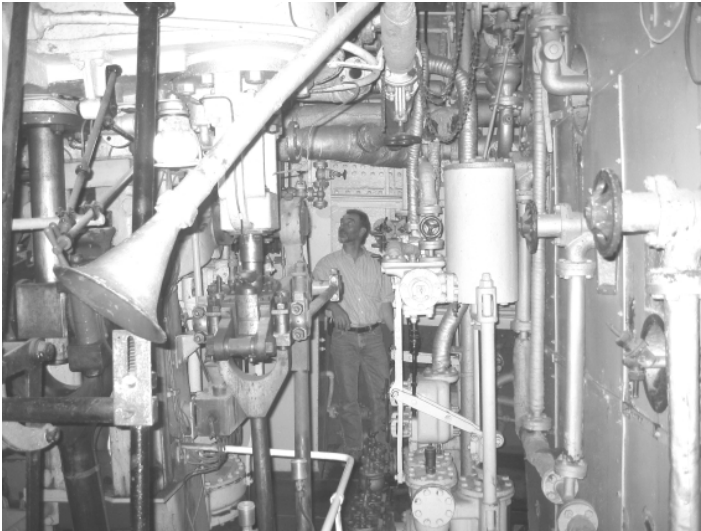
Im Maschinenraum der Rau IX
